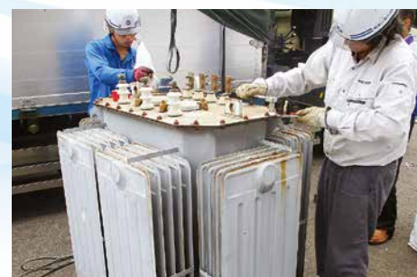
PCB廃棄物処分
