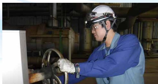
火力発電所の運転業務
