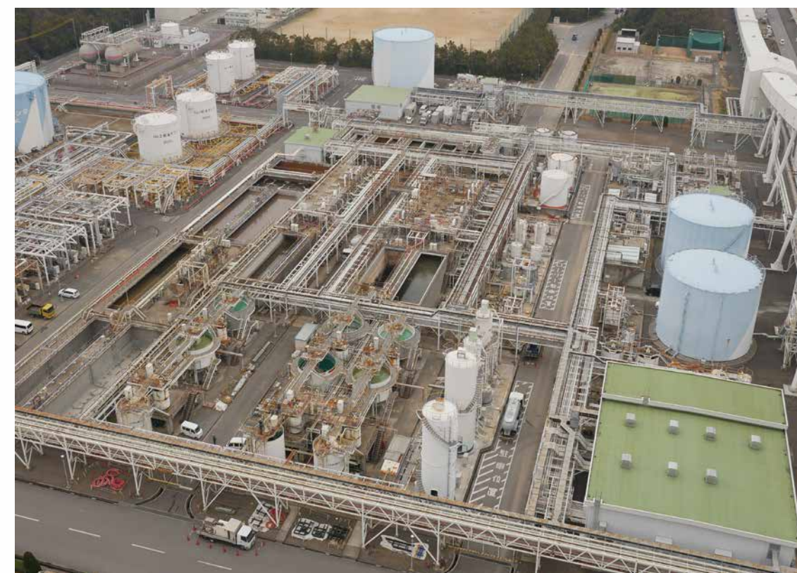
総合排水処理装置
