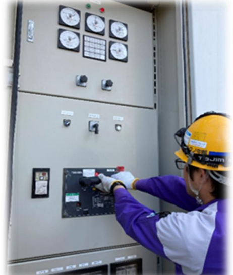
風車受変電設備の操作
